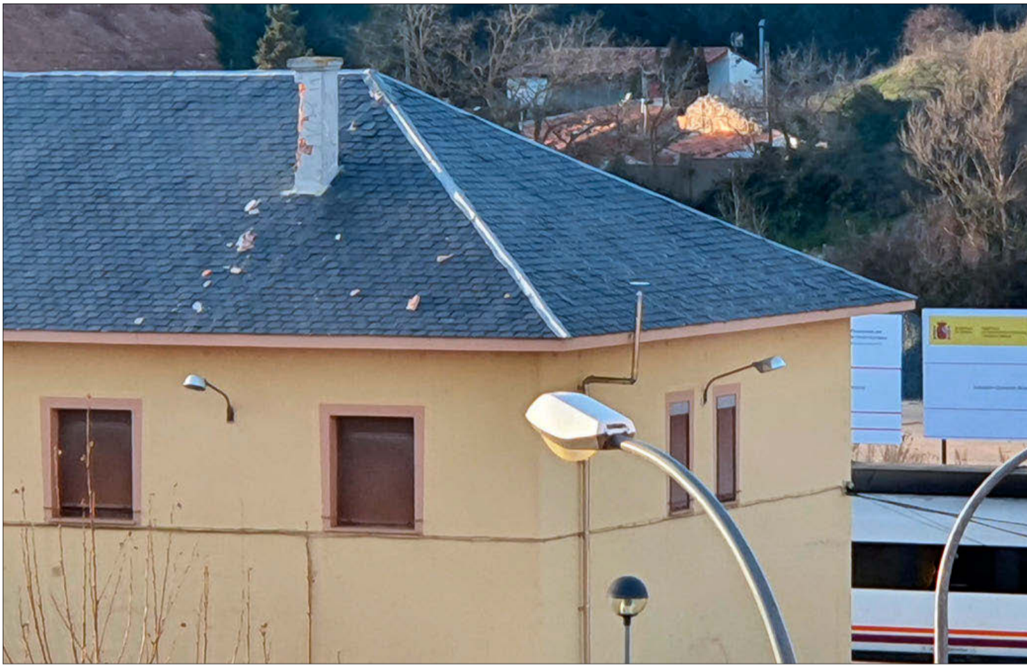
Imagen del edificio de la estación de tren con la chimenea que se cae a pedazos. HDS
